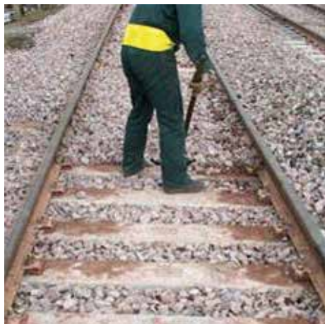
Arasement du ballast par rapport au niveau du dessus des traverses.
