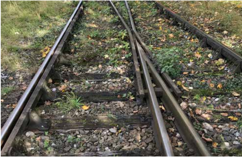
Figure 2 Végétation excessive sur les anciennes traverses en bois.
